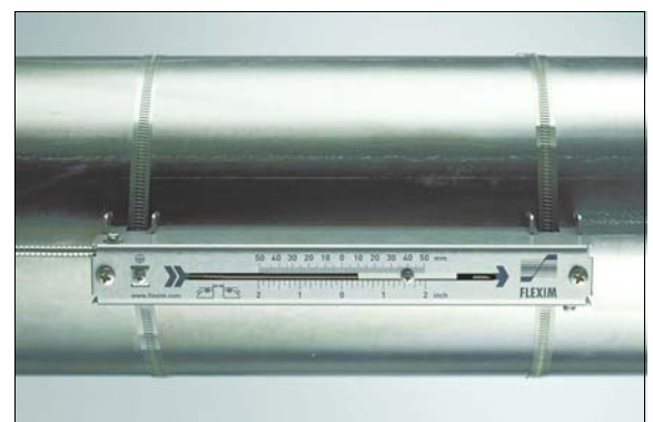
Измерение датчиками, смонтированными на Variofix L
